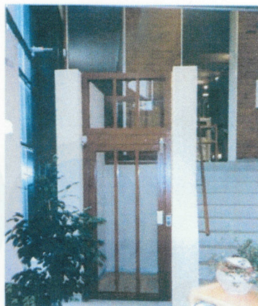
Personelevator på hotel.
